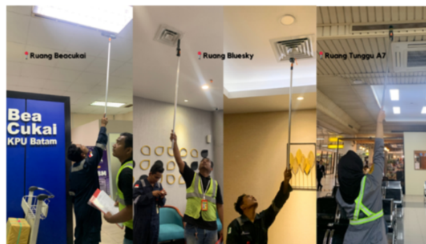
Gambar 1. 1 Dokumentasi Pendukung Pengecekan Temperatur
