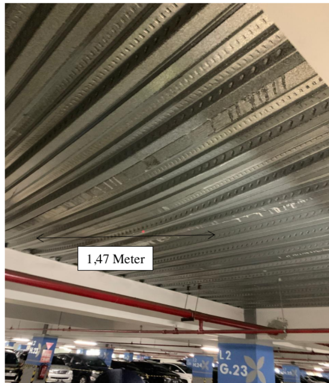
Gambar IV. 4 Penurunan Bagian Atas Bangunan Pada Daerah Parkir
