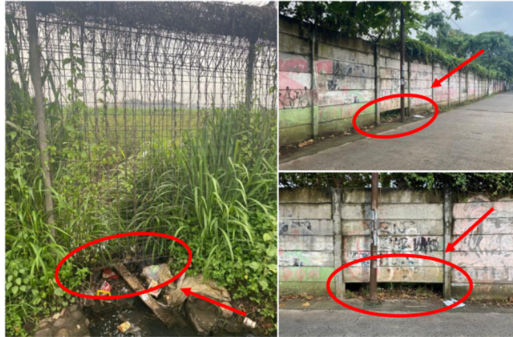
Gambar VI. 3 Pagar Perimeter dan Tembok Berlubang
