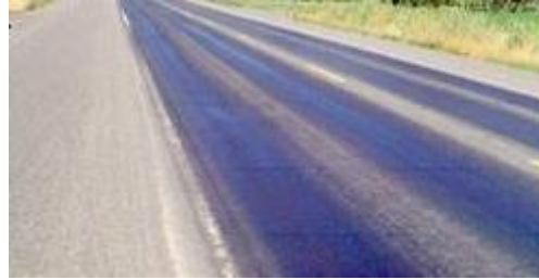
Gambar II. 19 Keluarnya material aspal ke permukaan
