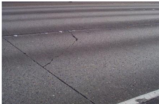
Gambar II. 22 Pecah sudut/Retak sudut
