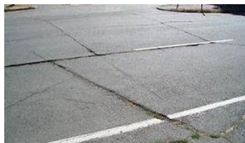
Gambar II. 7 Retak reflektif sambungan
