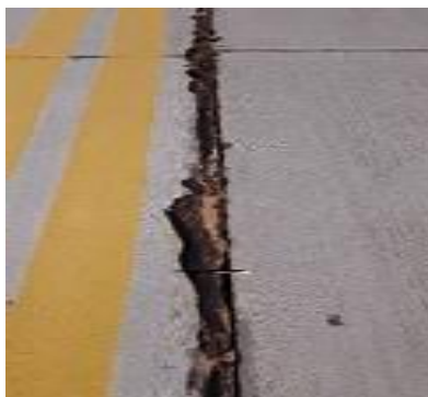
Gambar II. 25 Kerusakan penutup sambungan
