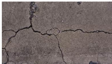
Gambar II. 28 Retak bersilangan pelat pecah
