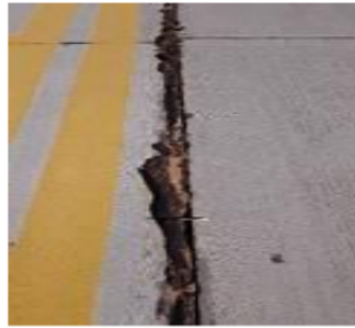
Gambar II. 25 Kerusakan penutup sambungan
