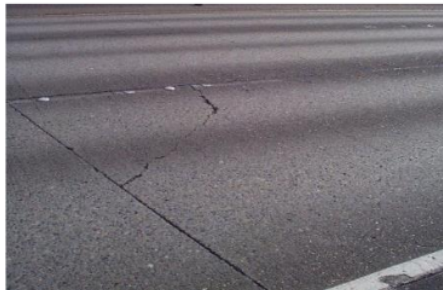
Gambar II. 22 Pecah sudut/Retak sudut
