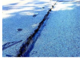
Gambar II. 32 Penurunan atau patahan ( Settlement/Faulting )
