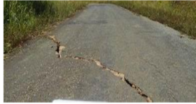
Gambar II. 27 Retak kehancuran ( Blow up )
