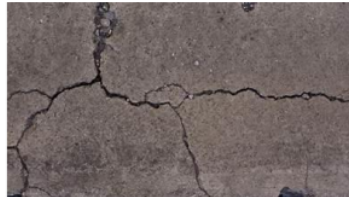
Gambar II. 28 Retak bersilangan pelat pecah
