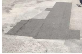
Gambar II. 30 Tambalan tidak sempurna patching
