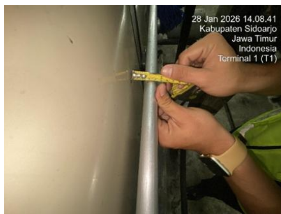
Gambar I. 1 Kerusakan pada AHU BL 01
