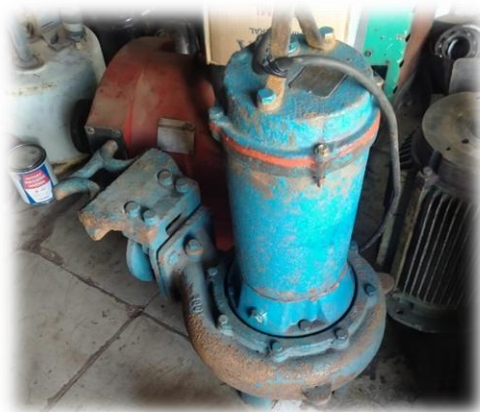
Gambar II. 1 Pompa Submersible 3 Fasa (Sumber : Unit TTEQ Injourney Airport Bandara SMB II PLM)
