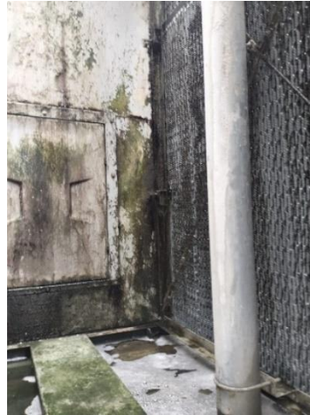
Gambar II. 4 Biofouling Pada Cooling Tower di Bandara Internasional I Gusti Ngurah Rai Bali (Sumber : Bandar Udara Internasional I Gusti Ngurah Rai Bali, 2025)
