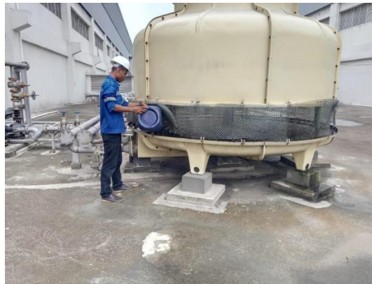
Gambar II. 5 Proses Chemical Dosing Manual Pada Cooling Tower (Sumber : PT. Bramasta Cipta Sempurna, 2025)
