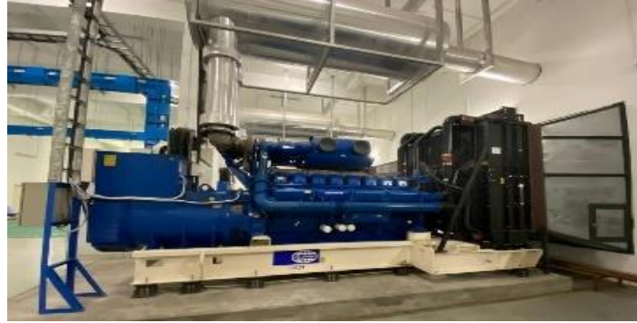
Gambar II. 1 Genset Bandara Juanda Surabaya (sumber : Dokumentasi Penulis. 2024)
