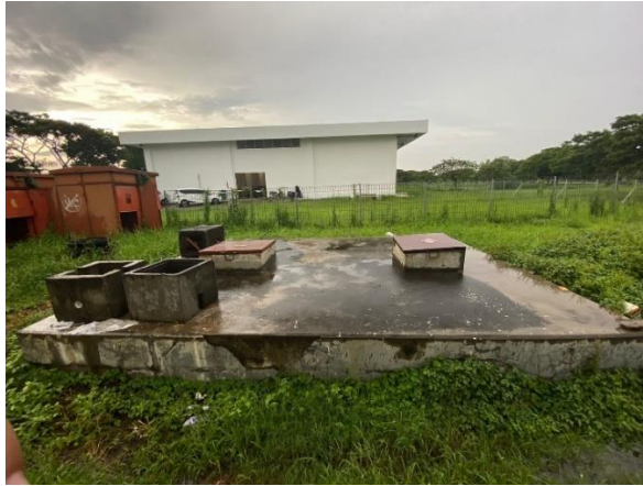
Gambar II. 2 Tangki Ground Genset terminal 2 Bandara Juanda Surabaya (Sumber : Dokumentasi Penulis. 2024)
