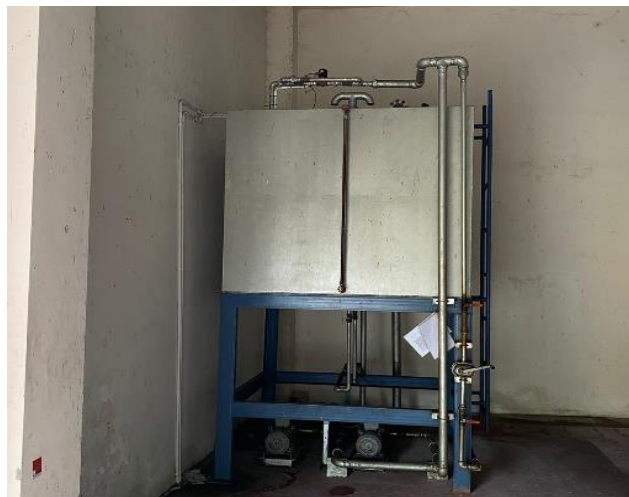
Gambar II. 3 Tangki Genset Harian Terminal 2 Bandara Juanda Surabaya (Sumber : Dokumentasi Penulis. 2024)
