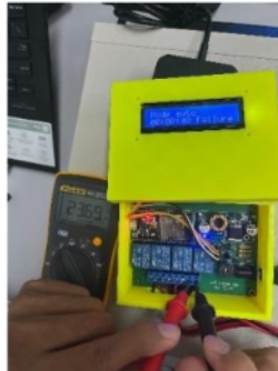
Gambar IV. 52 Uji tegangan AvioBridge failure (relay 4) Sumber:penulis
