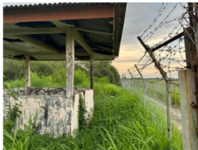
Gambar IV. 5 Clear Zone 3 meter yang Belum Terpenuhi
