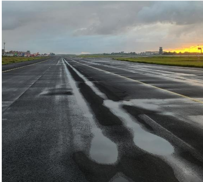
Gambar I. 4 Lendutan dan Standing water di Taxiway NP7 (Sumber: Penulis, 2026)
