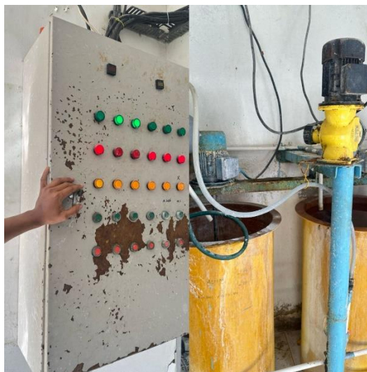
Gambar 1. 2 Panel Kontrol Pompa Dosing (Sumber: Dokumentasi Penulis)
