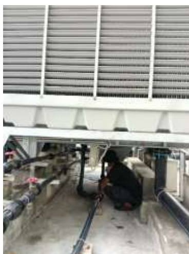
Gambar I. 2 Proses Blowdown yang dilakukan secara manual
