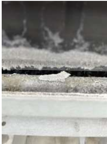
Gambar I. 1 Kerak yang menempel di Cooling Tower
