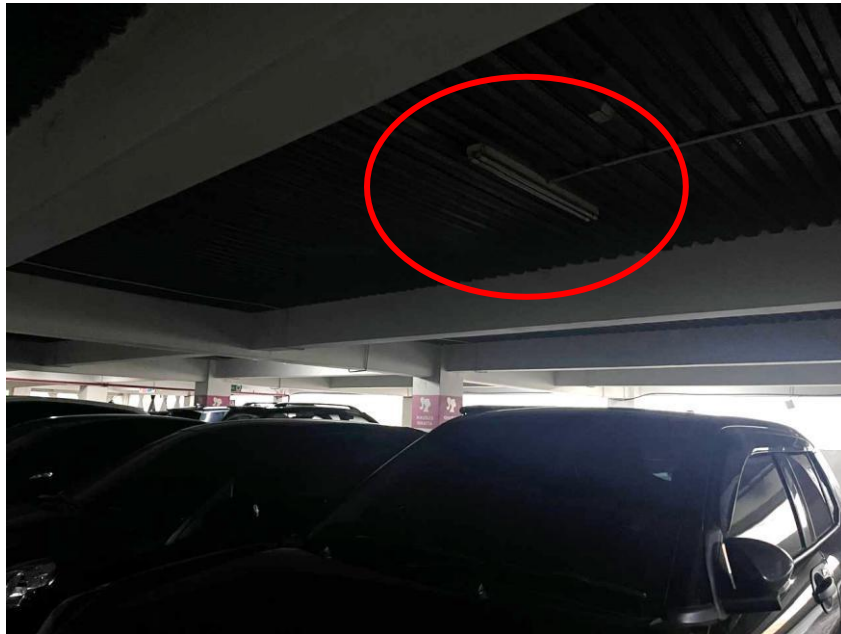
Gambar I. 2 Kondisi Lampu Mati dan Rusak pada Gedung Parkir (Sumber: Bandara Radin Inten II Lampung, 2026)
