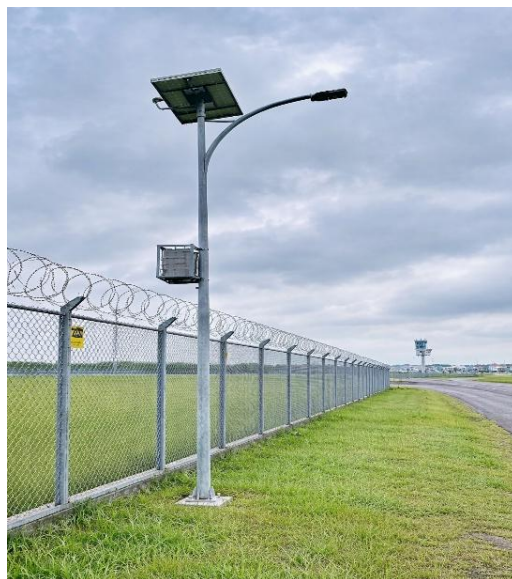
Gambar II. 3 Lampu Perimeter Bandar Udara SMB II
